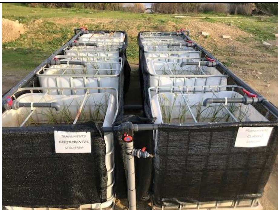
Planta pilot de tractament dels fangs procedents de la EDAR biològica de Raimat
